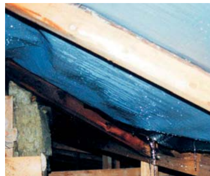
Aluskatteen "pussit" vuotavat. Vesi jäätyy ja sulaa pusseissa säävaihteluiden mukaan. Vesi valuu yläpohjan rakenteisiin. Aluskatteen asennustapa on puutteellinen. Aluskate on liian löysällä.
